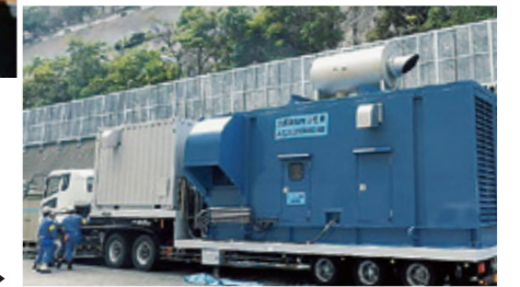
新たに空冷式非常用発電装置を高台に配備▶
