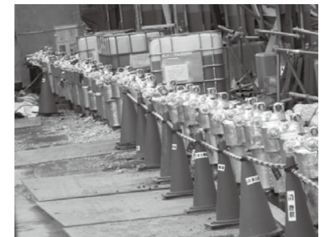
凍土遮水壁のパイプ
